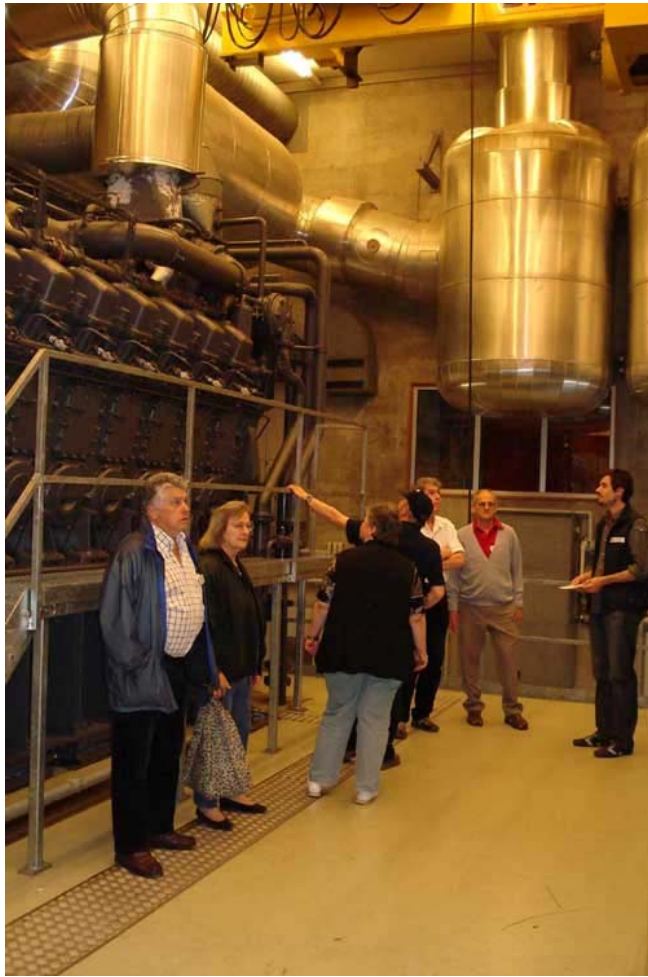
Besichtigung der Notstromaggregaten mit über 5'000 PS.
